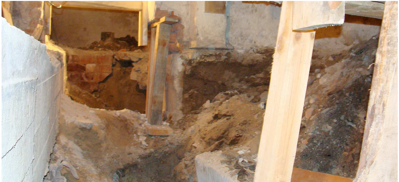
8. Zapadnięte szamba, urwane fundamenty pod ścianami podłużną i wschodnią, podstemplowane
