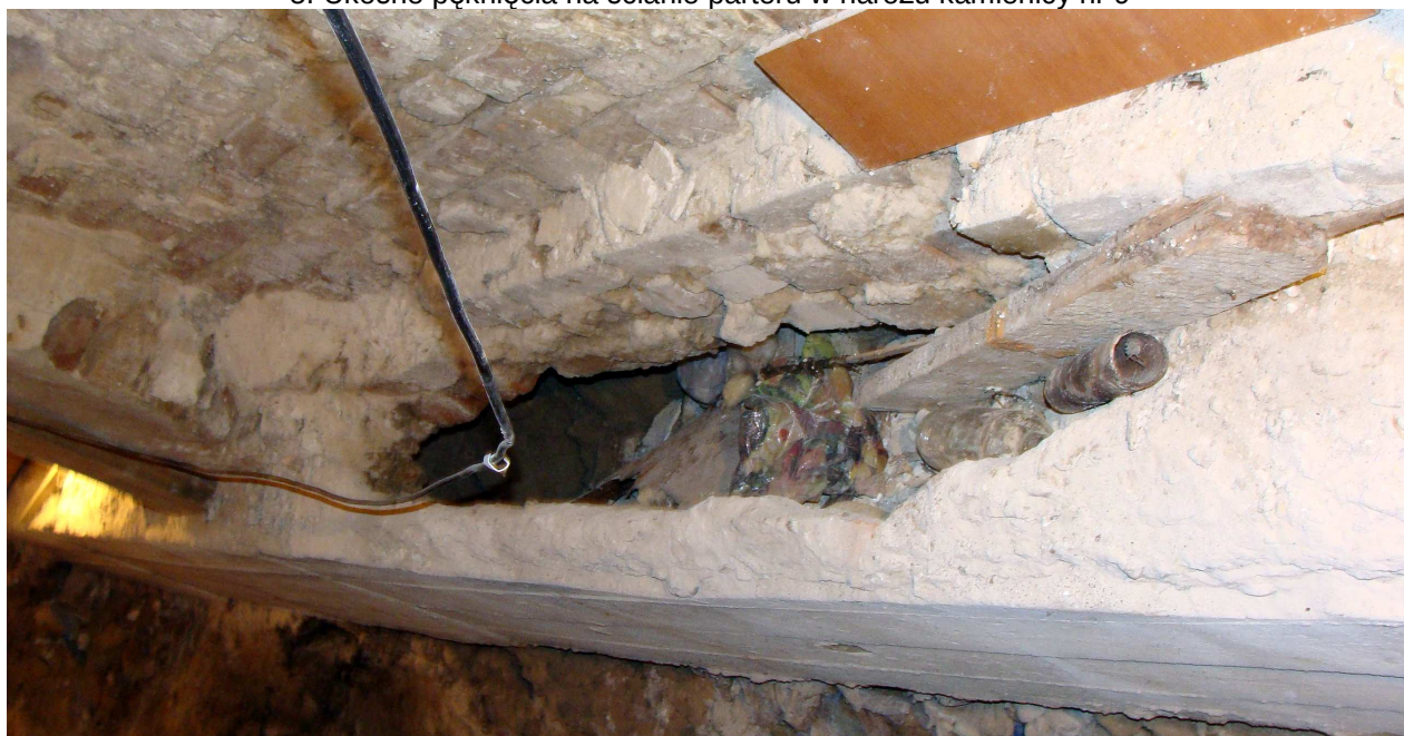
6. Zapadnięty grunt pod ścianą północną pod budynkami nr 9 i nr 11, wyrwa zasypała śmieciami
