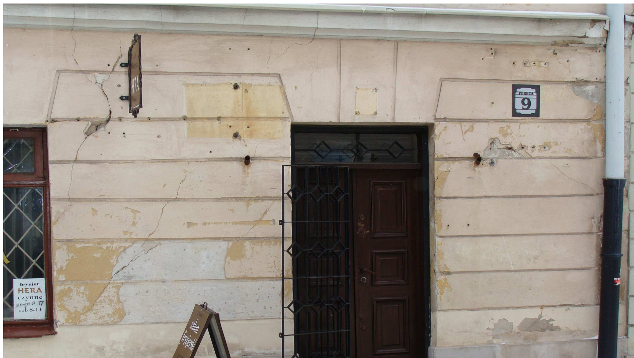
5. Ukośne pęknięcia na ścianie parteru w narożu kamienicy nr 9
