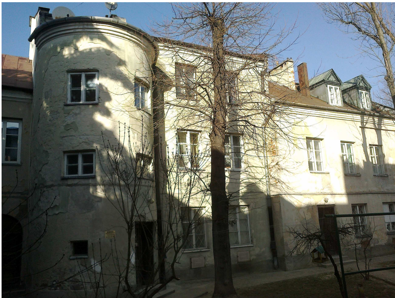
3. Elewacja południowa – od strony podwórza. Odpadający tynk, zawilgocone dolne partie ścian.
