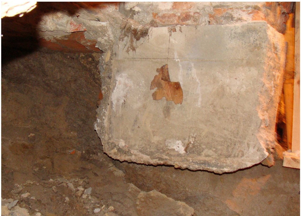
9. Zawieszona stopa fundamentowa nad osuwiskiem , pod narożem ściany wschodniej i podłużnej
