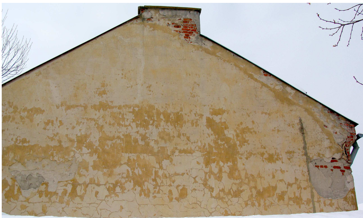
2. Elewacja szczytowa – wschodnia , ponad budynkiem stacji trafo. Pęknięcia i złuszczenia tynku. Przy północnym gzymsie widoczna stalowa kotew spinająca budynek.
